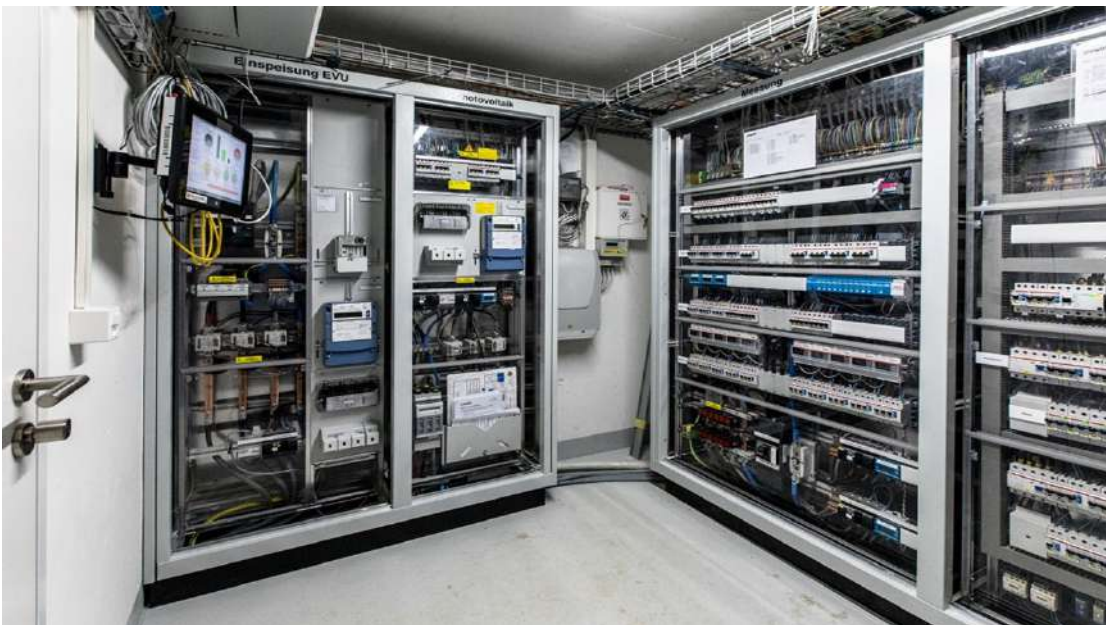
Abbildung 43: MFH in Wetzikon AG, Technikraum mit EMS und Zähler für ZEV-Abrechnung (Quelle: Arento AG)
