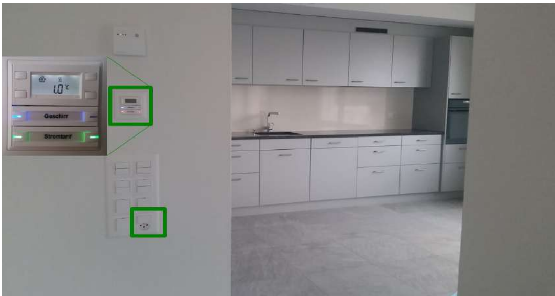
Abbildung 48: Blick in eine Wohnung mit KNX-Raumbediengerät (aktive Beeinflussung der Raumtemperatur, Anzeige von PV-Strom, Solarsteckdose und PV-optimierter Betrieb des Geschirrspülers)
