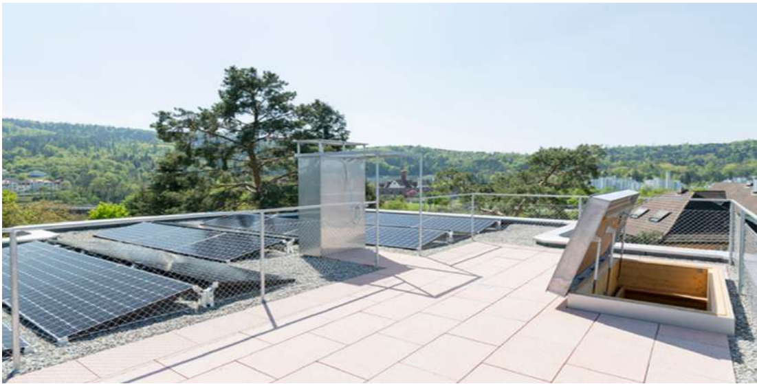
Abbildung 37: MFH in Wettingen AG, PV-Anlage auf Dach (Ost-West) (Quelle: Hürzeler Architekten AG)
