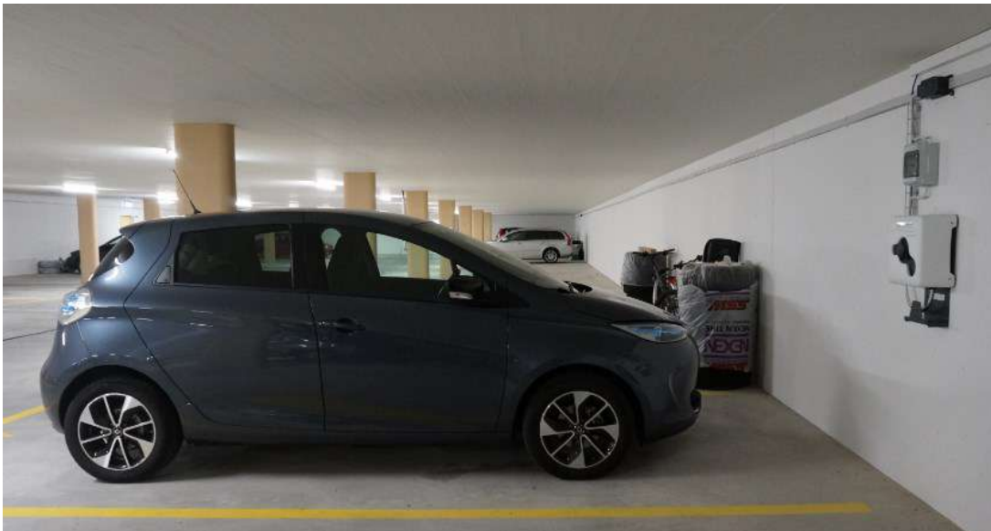
Abbildung 49: Tiefgarage Möriken AG mit Elektromobilität (Flachbandkabel vorinstalliert)
